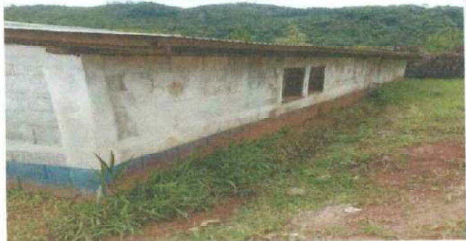
Foto1: Vista panorámica lado posterior de aula No. 2, con presencia de humedad en paredes.
