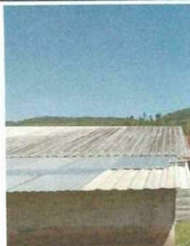
Foto 2: Cubierta de aula No. 2 con visible deterioro.
