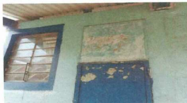
Foto 6: Paredes exterior de dirección con deterioro.
