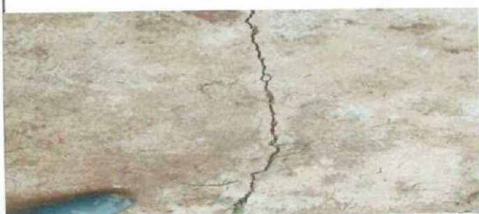
Foto 3: Piso de torta de concreto con grietas.
