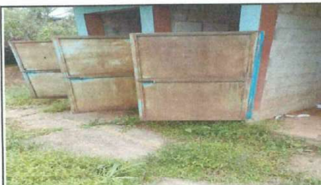
Foto 4: Puertas de sanitario con presencia de óxido.
