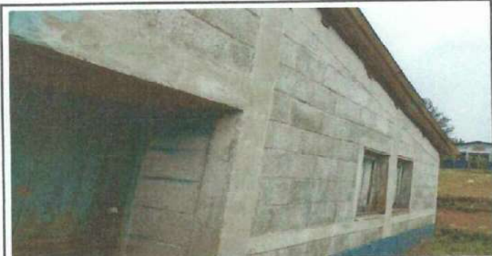
Foto 5: Puerta de Aula No. 2 con deterioro por humedad por ser de madera.
